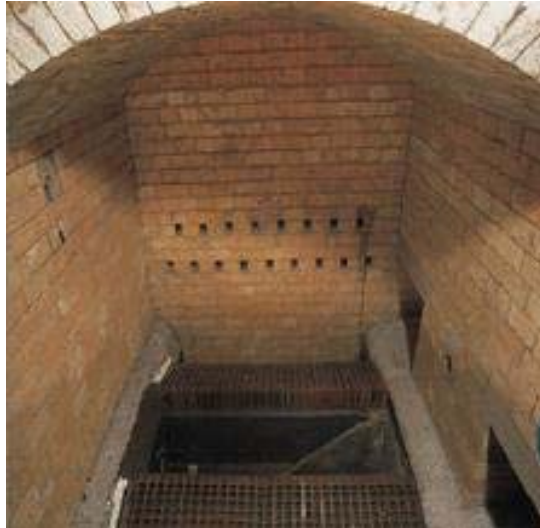
Figura 3 Camera di combustione di una caldaia a biomassa
