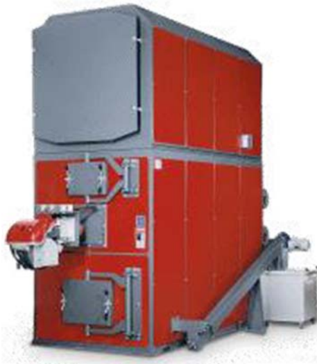
Figura 4 Caldaie 2 - Generatore ad acqua calda con scambiatore a tubi di fumo orizzontale presente in centrale termica
