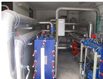
Figura 2 Sottostazione di utenza
